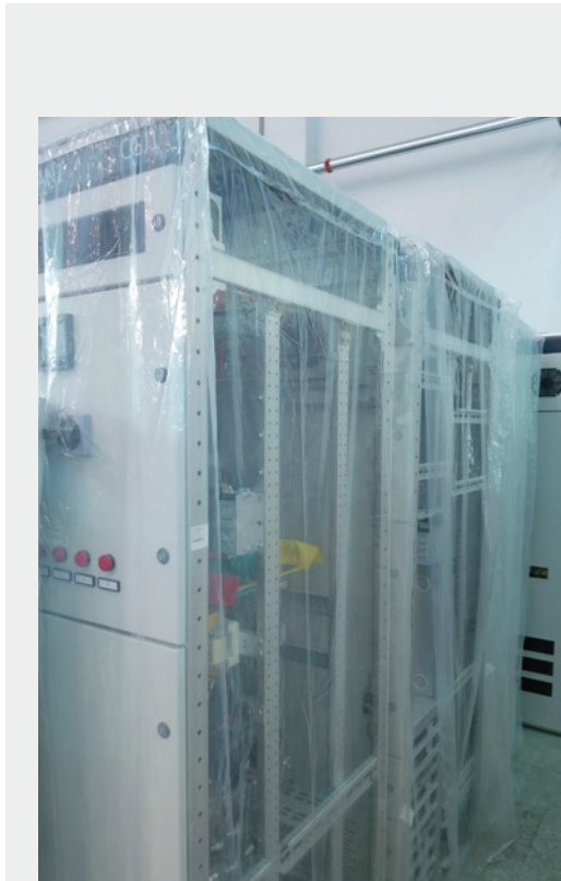
GT-Labor für Inselnetze im Gebäude 建筑电气与智能化实验室建筑内部岛屿网络实验设备
